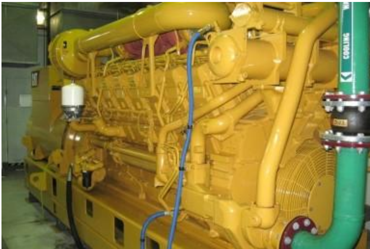
Interno della Hybrid Power Station
